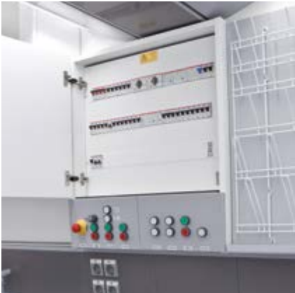
La subdistribución eléctrica integrada se encarga de la protección por fusible de todos los consumidores eléctricos.
