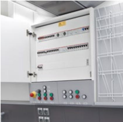
La distribution électrique intégrée prend en charge la protection de tous les consommateurs électriques.
